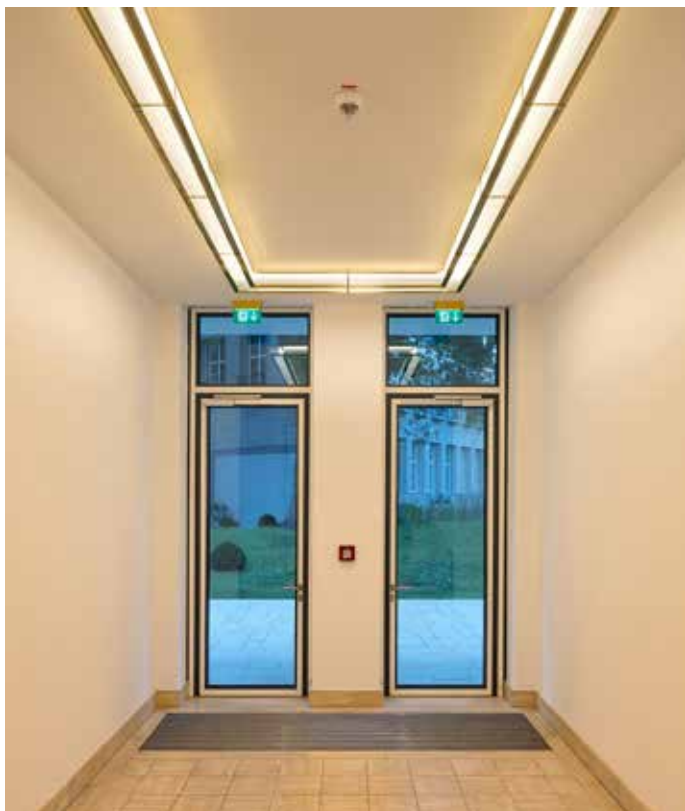
Abb.: Die Rettungszeichenleuchten sind mit einem Überwachungsmodul ausgestattet und an einer Zentraleinheit angeschlossen. Eine Pulverbeschichtung in Gold ist ihr Tribut an das edle Ambiente.
